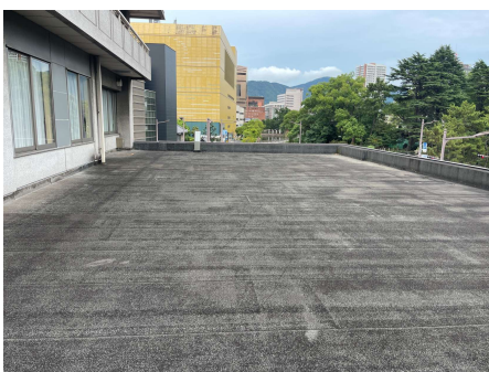
既設防水浮き部
